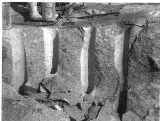
B 岩盤法面景観工法「油圧式割岩装置 (V4)」 写真—5 油圧式割岩装置 (V4) 割岩状況
