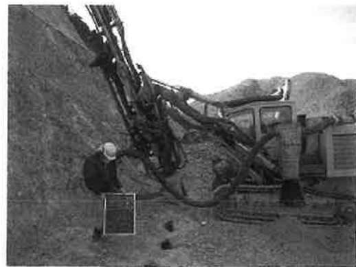
A 岩盤法面整形工法「特殊楔型チゼル」 写真—4 特殊楔型チゼルセット状況
