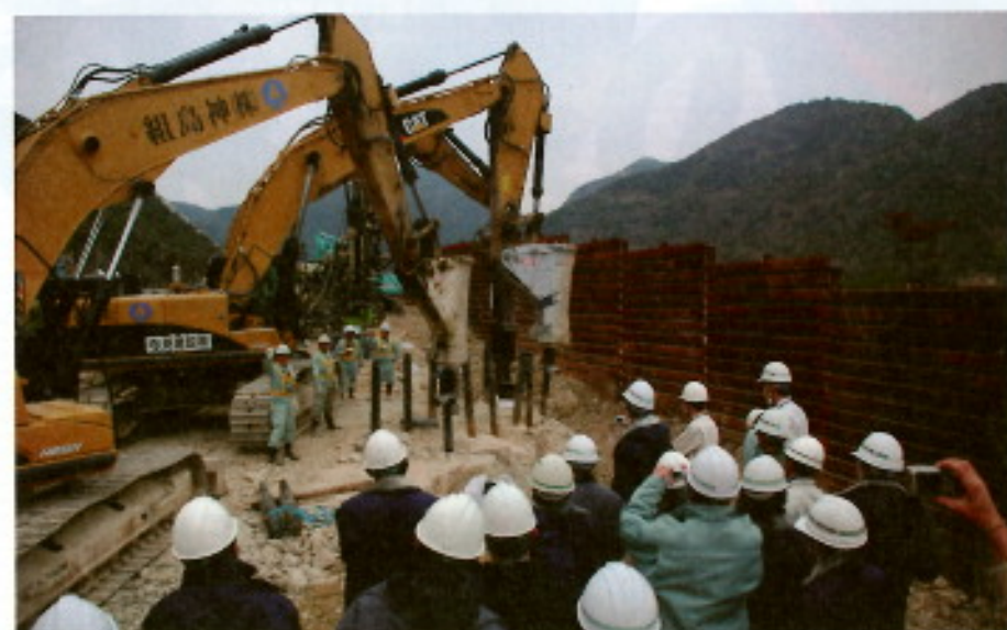
3月に岡山県で実施した現場見学会の様子。奥に見える複数の黒い棒が神島組開発のチゼル「かち割り君」。大型ブレーカーでチゼンを押し込んで岩を割裂させている(写真:33ページまで特記以外は本誌)
