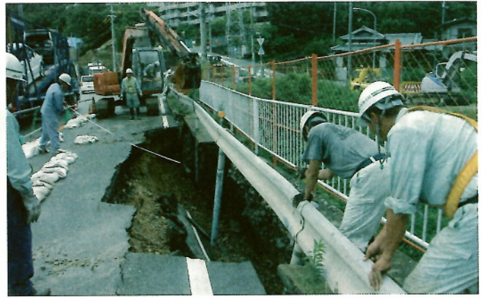
09年8月の記録的豪雨で現場から約30m離れた国道176号が崩壊。神島組が応急処置に当たった。この災害復旧工事は、後から契約に組み込まれた
