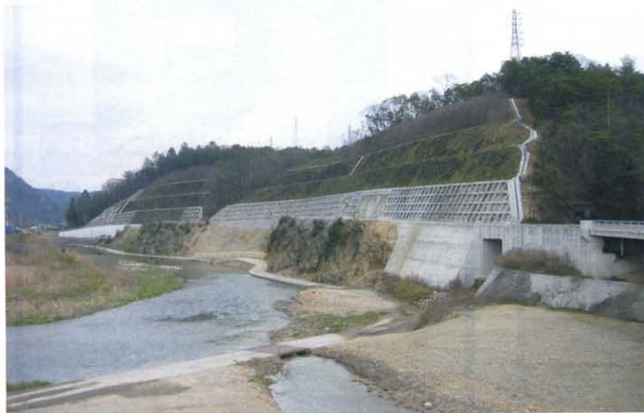
神島組が2003年に手がけた工事の一つ、「武庫川上流流域下水道事業県道切畑道場線バイパス工事」。発注者は兵庫県阪神南県民局。阪神地域ではこうした工事の際、地面や法面で岩が作業に障害をもたらすケースが少なくない (写真：特記以外は神島組)
