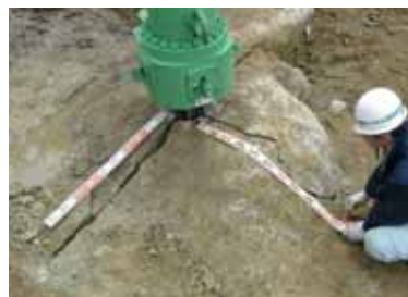
写真 - 3 破碎状況
