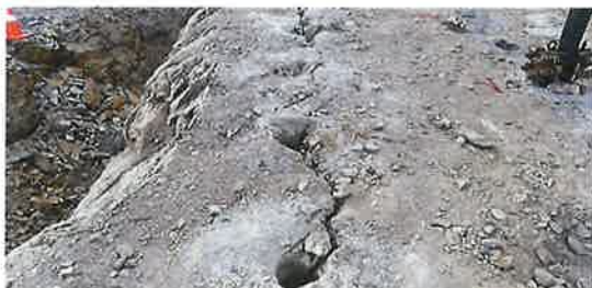
「特殊くさび式割岩装置（Wボルト仕様）」引抜後亀裂状況
