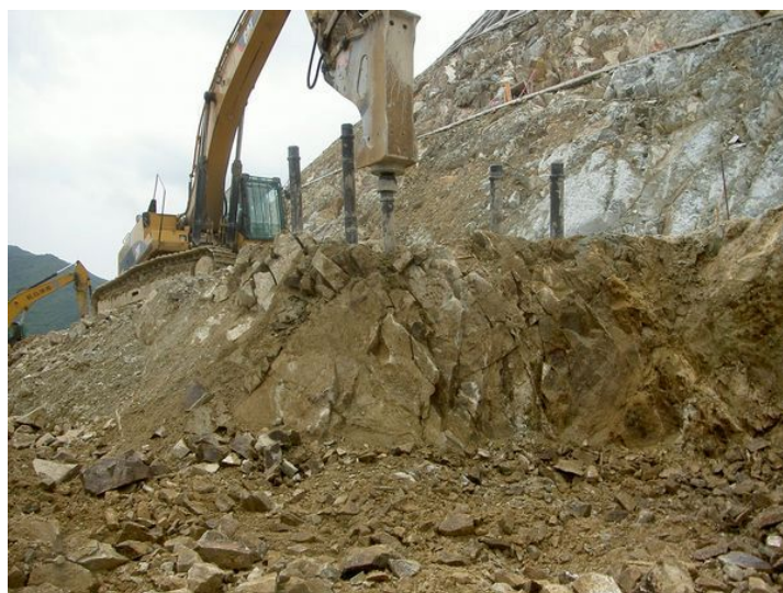
3mベンチ破碎状況
