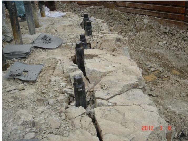
連続した割裂状況
